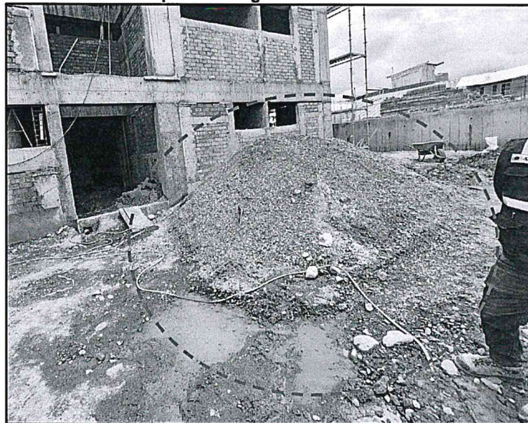
Panel Fotográfico n.º 2 Agregado Pétreo En Contacto Directo Con El Suelo Y Expuesto A Agentes Atmosféricos
